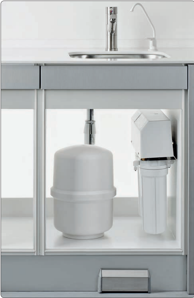
MELAdem®47 mit Entnahmehahn und Vorratsbehälter in einem Unterschrank montiert
